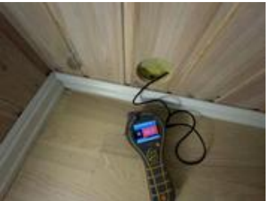
Det ble ved hulltaking påvist forhøyede fuktverdier i bunn av påforet vegg i kjellerstue.
