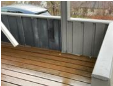
Rekkverk på terrasse er for lavt iht krav i dagens forskrifter.
