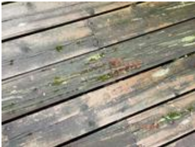
Råteskader i enkelte terrassebord på terrasse fra byggeåret.
