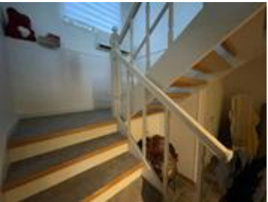
Innvendig trapp. Åpninger i rekkverk er større enn krav i forskrifter samt det er ikke montert håndløpere på vegg.
